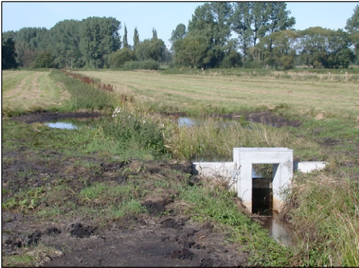
Abb. 6: Regelbares Staubauwerk in einem Graben im Block III (Foto: D. Esplör).
