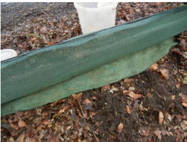
Auf den ersten Blick sieht das nicht schlimm aus. Tatsache ist aber, dass beim ersten Regen die lockere Erde den Hang hinunter geschwemmt wird, wodurch der Zaun untertunnelt wird.
