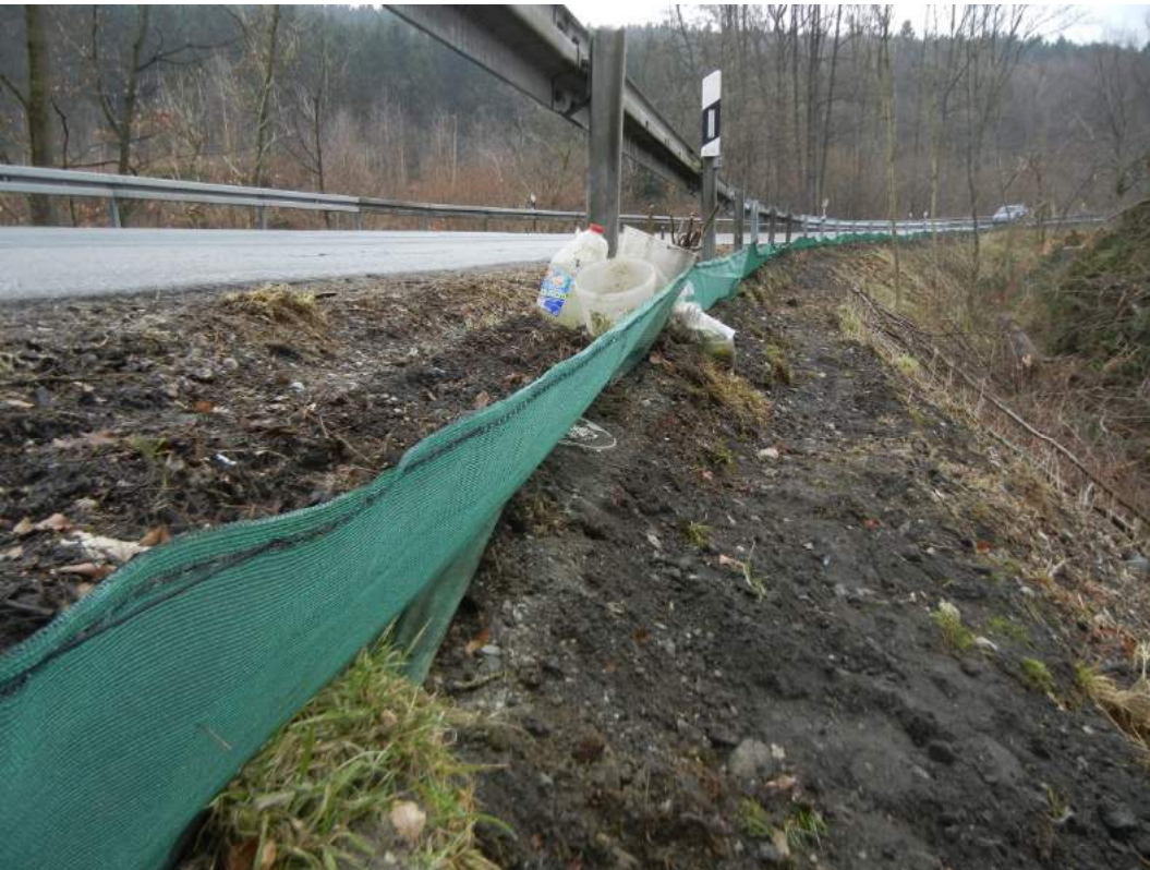
Nicht nur, dass Eimer fehlen, nein, teilweise sind sie auch so bescheuert eingebaut. Was sieht jeder? Die Straße zeigt eine Neigung zum Zaun und zum Hang. Ein Regenschauer und der Eimer ist mit Wasser gefüllt bzw. wird aus dem Loch geschwemmt.
